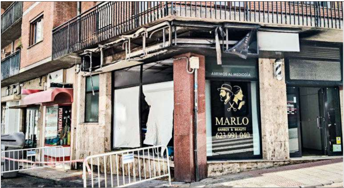
Estado en el que quedó la peluquería junto a los contenedores incendiados. HDS
